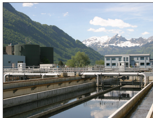
Figura 14 – Stație de epurare a apei
